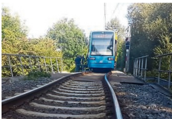
Durch die Kollision eines Lastwagens mit der Haferbachbrücke Niederkaufungen im August 2019 hatten sich die Schienen verzogen.
